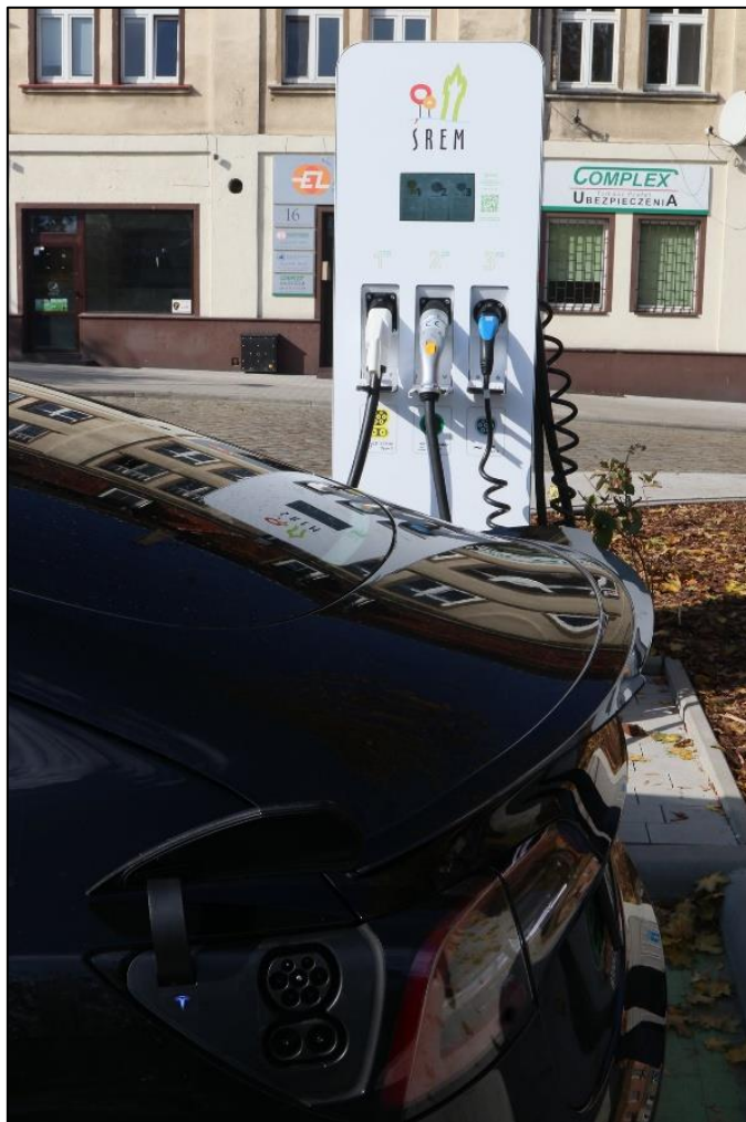
Rysunek 19 Stacja ładowania pojazdów na terenie centrum przesiadkowego
