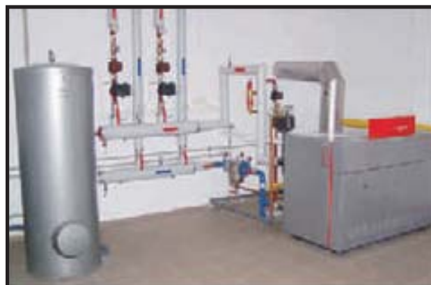
13. Zmodernizowana kotłownia w Szkole Podstawowej w Pyszącej 2005r.
